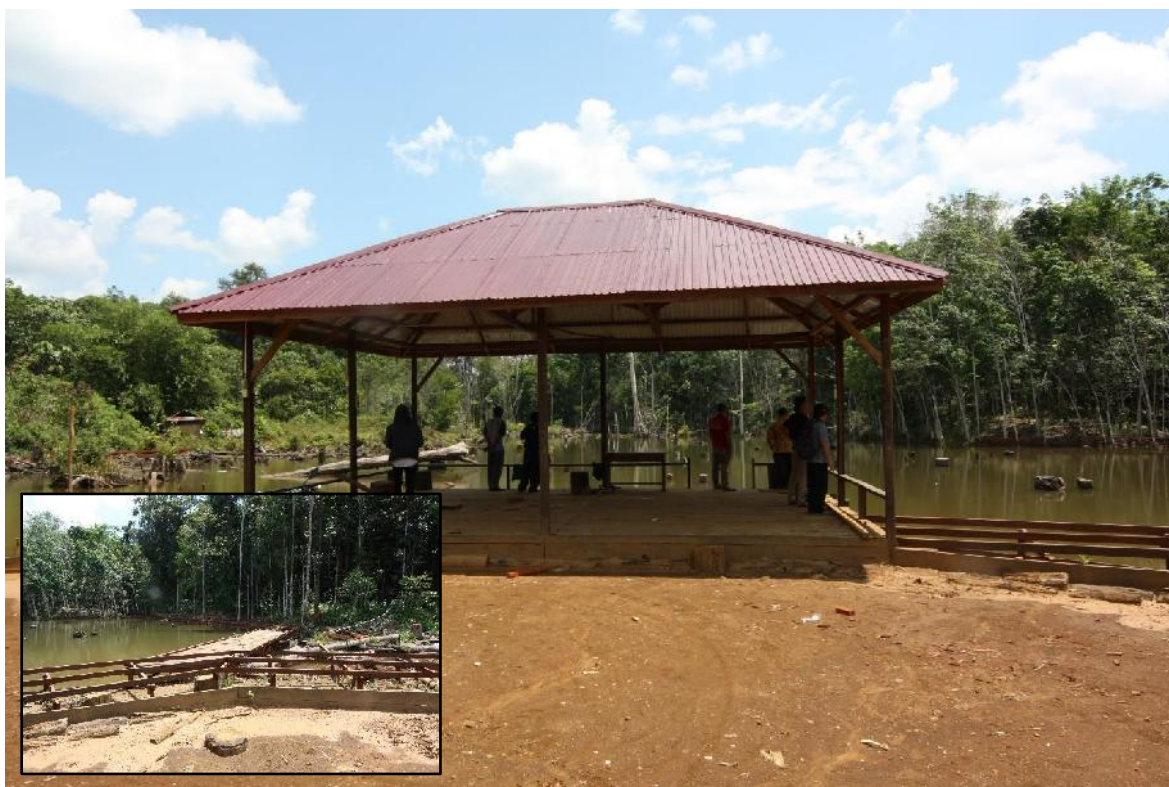
Gambar 13. Danau buatan yang berada di pinggir hutan Hemaq Beniung serta pembangunan fasilitasnya
